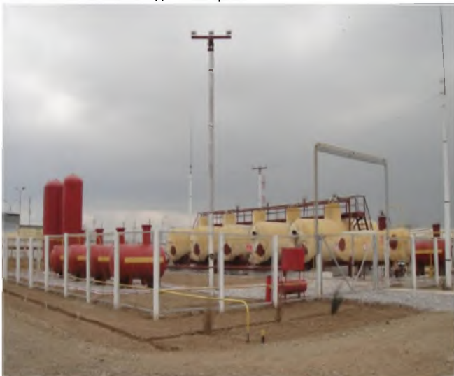
Биогазовая установка МТФ на 600 м 3 /сутки.
