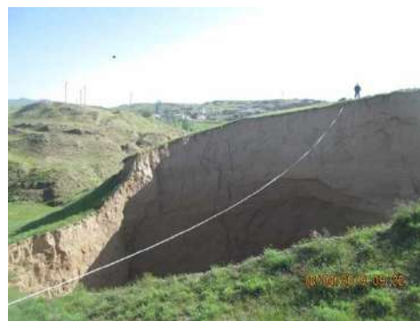
Рис. 5. Общий вид, провальная воронка (по состоянию на 18.04.2019 г.)
