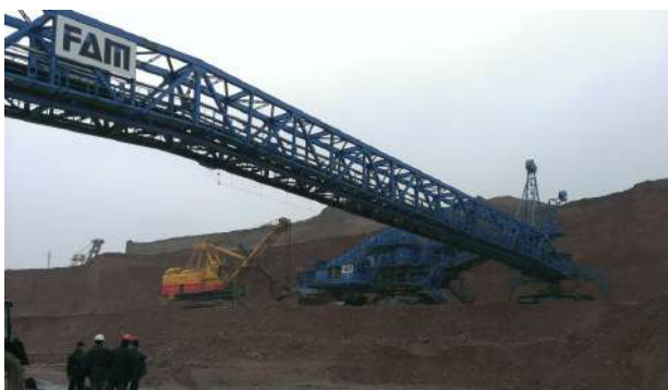
Рис. 3. Комплекс мобильной дробилки с мостовым перегружателем, фронтальный вид
