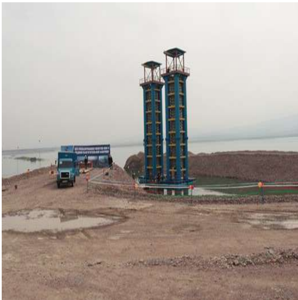
Фото. Кольцевой водоприёмный коллектор № 4 (KBK-4)
