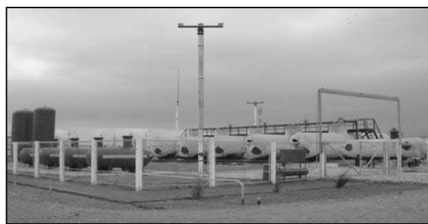
Рис. 2. Общий вид биогазовой установки МТФ
