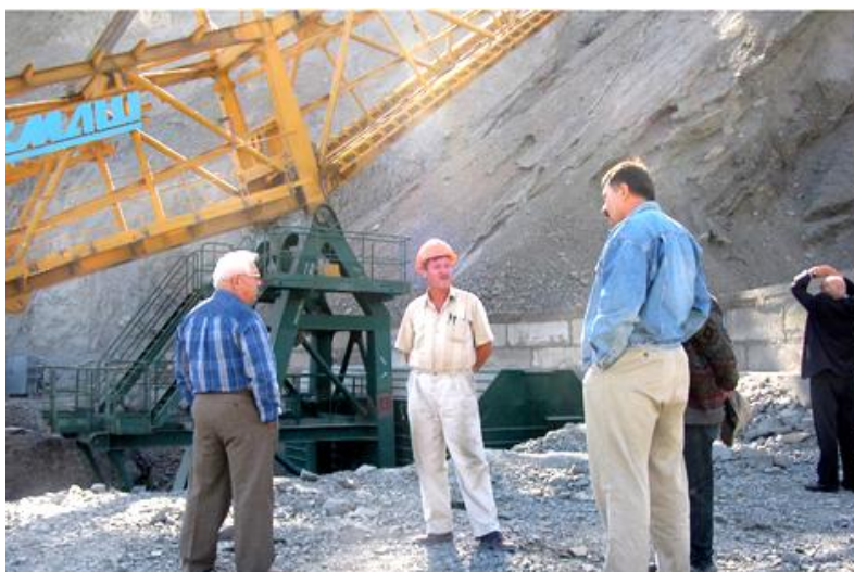
Рис. 7. Главный механик НГМК Кодоев В.С. (справа), главный механик Центрального рудоуправления Хутиев Л.А. (слева) и ведущий конструктор ОАО «ГСКТИ» Олейник С.Л. (в центре) обсуждают ход монтажа КНК-30 на карьере Мурунтау
