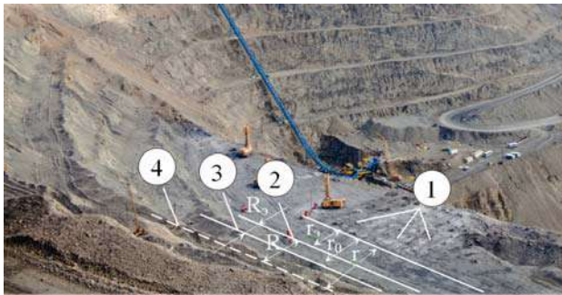
Рис. 1. Схема к расчёту коэффициента эффективности применения контурного взрывания: 1 – заряды дробления в приконтурной зоне; 2 – проектный контур (экранирующая щель); 3 – граница зоны остаточных деформаций при наличии экранирующей щели; 4 – границы зоны остаточных деформаций при взрыве без экрана
